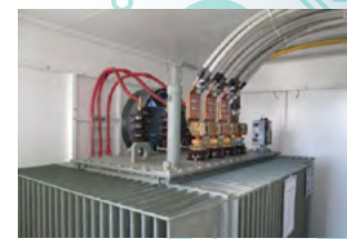
CABINE DI TRASFORMAZIONE
